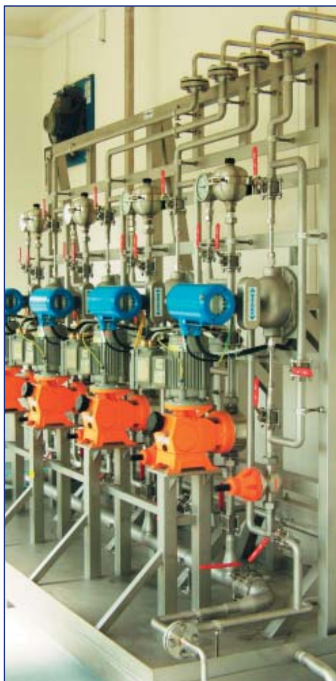
Dávkovací čerpadla methanolu na čistírně odpadních vod v Hradci Králové.
