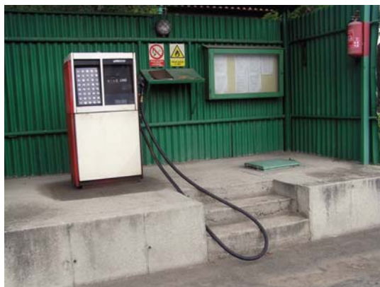
čerpací stanice pohonných hmot vhodně zabezpečená proti únikům ropných látek i vlivu srážkových vod
