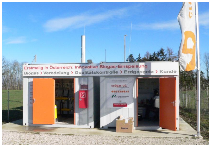
Obr. 8 Čisticí a stlačovací jednotka u menší bioplynové stanice v Puckingu (Rakousko)
