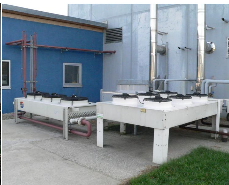
Obr. 6 Chladiče pro chlazení motoru kogenerační jednotky
