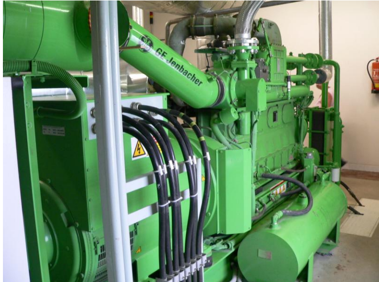
Obr. 7 Kogenerační jednotka fy GE Jenbacher
